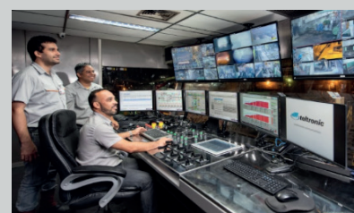
Nova cabine de controle da laminação de tiras a quente
