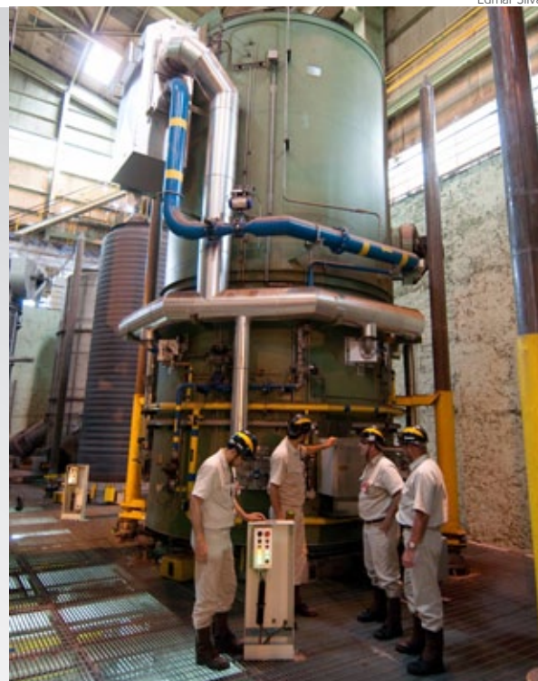
Box RC4 passou a operar com 100% de hidrogênio no recozimento das bobinas de aços Inox
