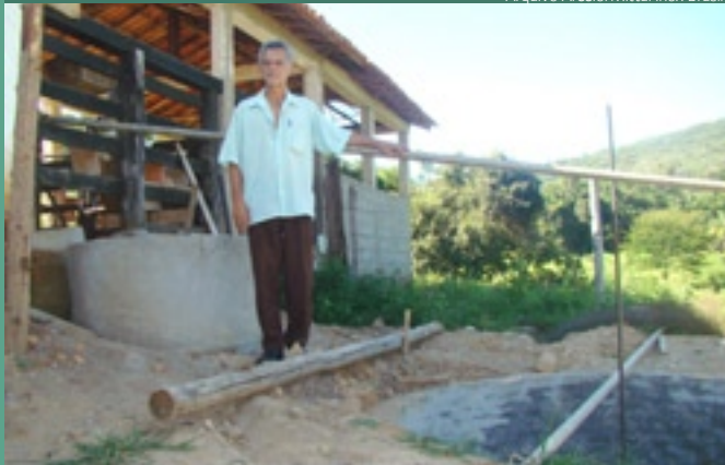
Antônio Valdir instalou o biodigestor ao lado da casa de ordenha
