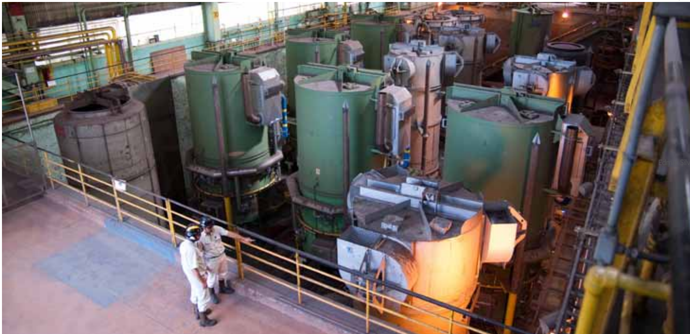
Aquecedores da Aciaria 2 já estão operando com gás natural
